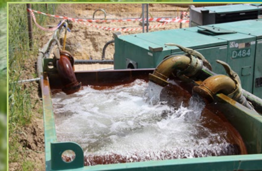
Lozing grondwater via beluchting op oppervlaktewater
